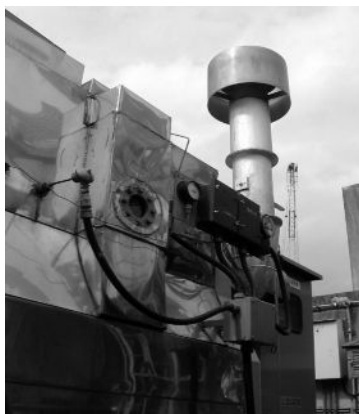
▲冷温水発生機
